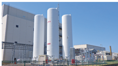
新設したLNG貯蔵タンク
